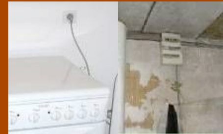
Réseau électrique descendant, ré hausse des prises
